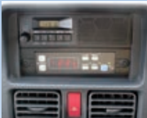
冷凍機コントローラー
